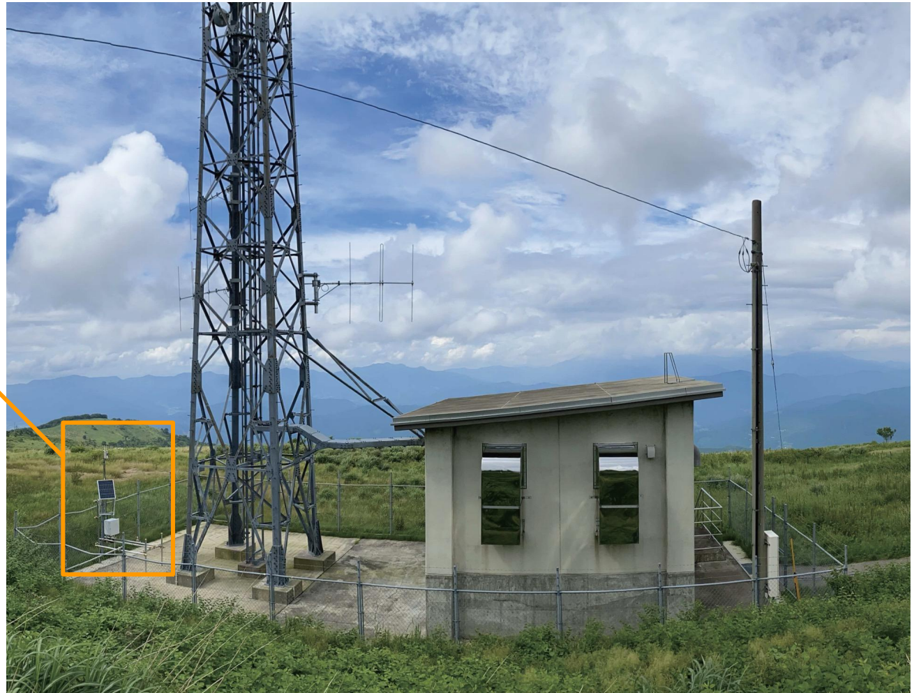
従来の鉄塔無線設備との比較
